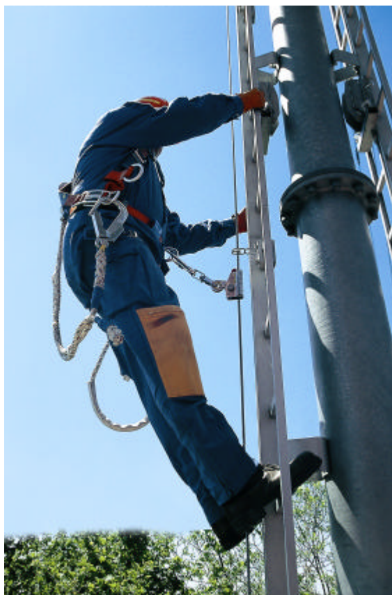
Bild 16: Beispiel einer Steigschutzeinrichtung mit Führung aus Stahldrahtseil
